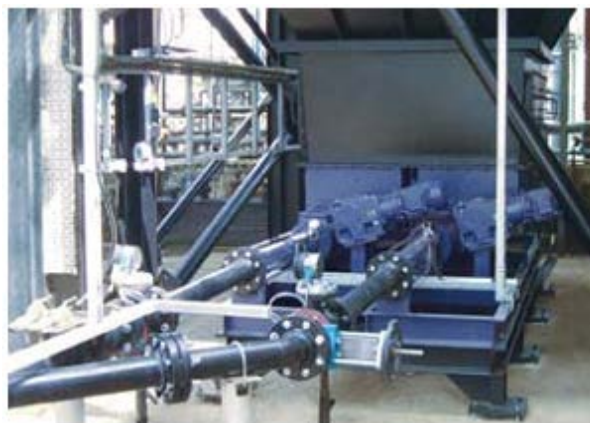
Pompe gama BTEI 17-24 instalate sub silozul de recepție Produs de transport: Turtă de nămol uleios cu un conținut ssu de 60% Capacitate de transport: 4 m 3 /oră (17 GPM) Presiune: 16 bar (232 PSI) Temperatură: 5-40°C (41-104°F)
