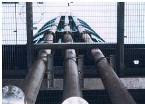
Distanțe lungi – chiar și vertical Pompele seepex nu numai că transportă nămolul deshidratat orizontal pe distanțe lungi. Capătul vertical - 30 m (98 ft) până la partea superioară a silozului – nu reprezintă o limitare.
