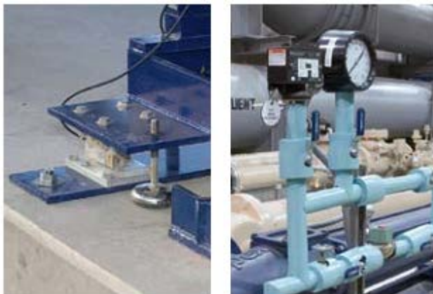
Celule de încărcare, control al debitului și presiunii
