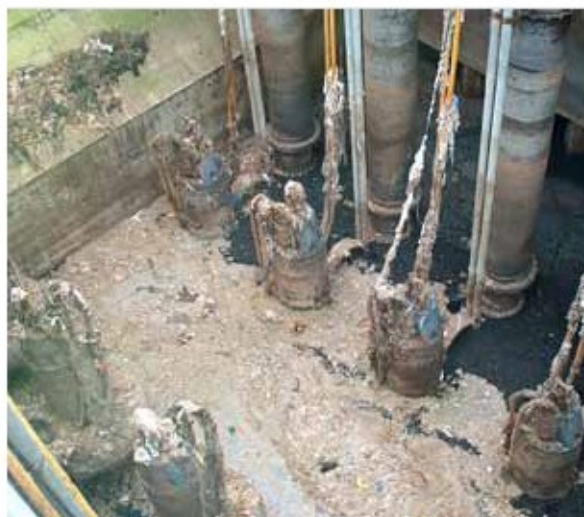
Statie de pompare cu acumulare de reziduuri plutitoare.
